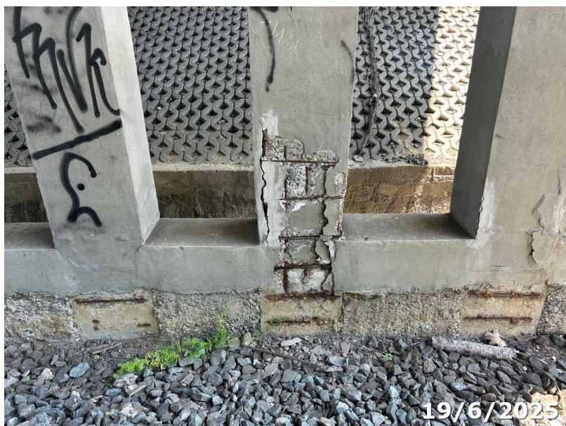
Obr.12 P2, separovaná krycí vrstva, koroze obnažené výztuže
