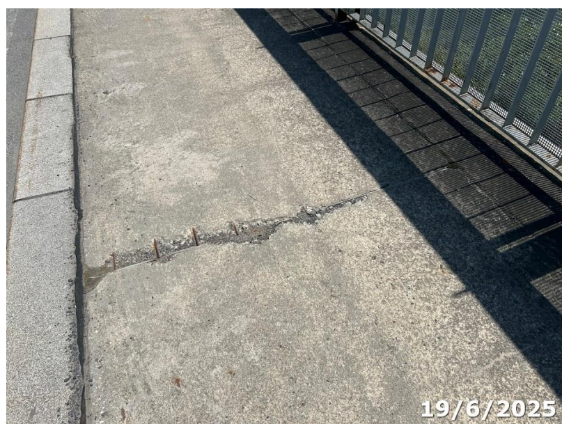
Obr.27 Smršťovací spára v římse, obnažená výztuž
