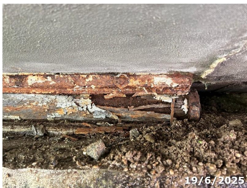
Obr.8 OP1, válcové ložisko, zničené korozí
