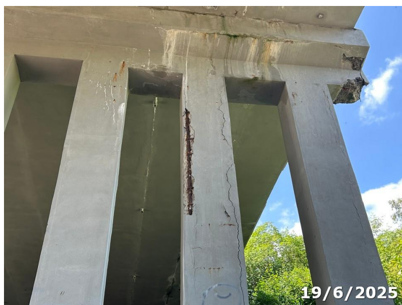
Obr.14 P3, pravý okraj stativa, výluhy, korozní produkty
