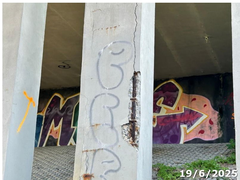
Obr.15 P3, druhý sloup zprava, obnažená korodující nosná výztuž
