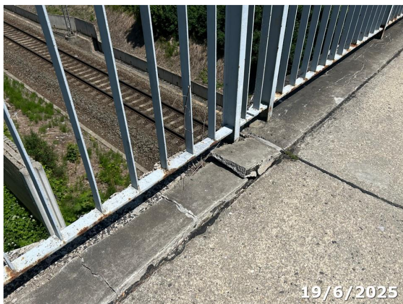
Obr.25 Degradace betonu římsy vpravo, pohled z chodníku
