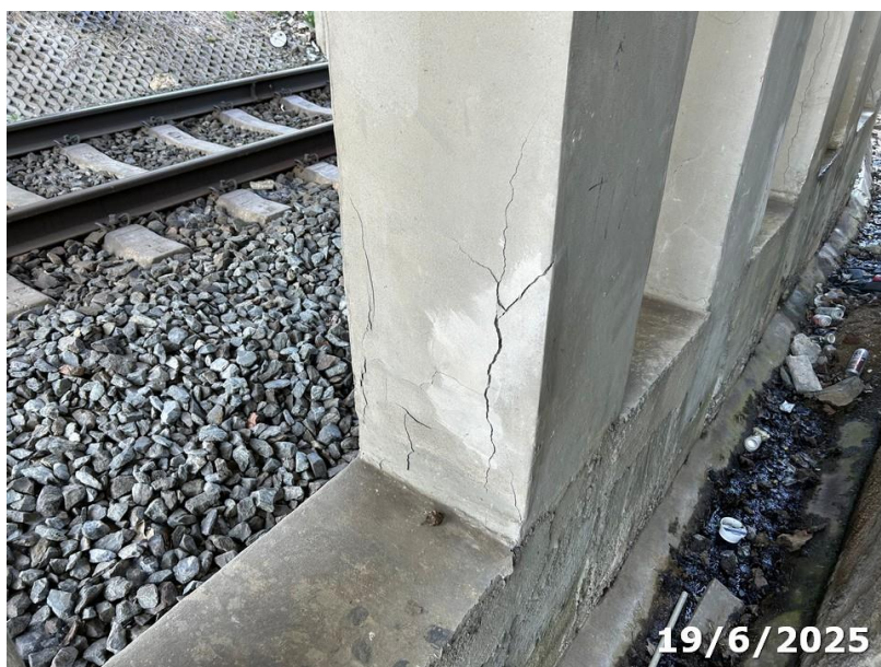
Obr.11 P2, trhliny v sanační vrstvě, separace
