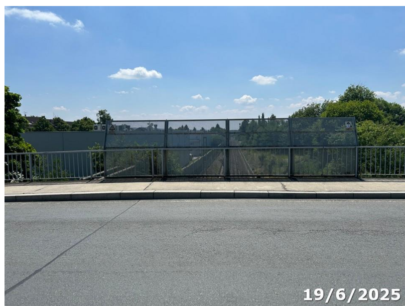
Obr.35 Protidotyková zábrana vlevo
