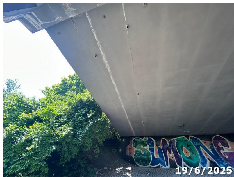
Obr.23 Podhled pole 3, levý okraj
