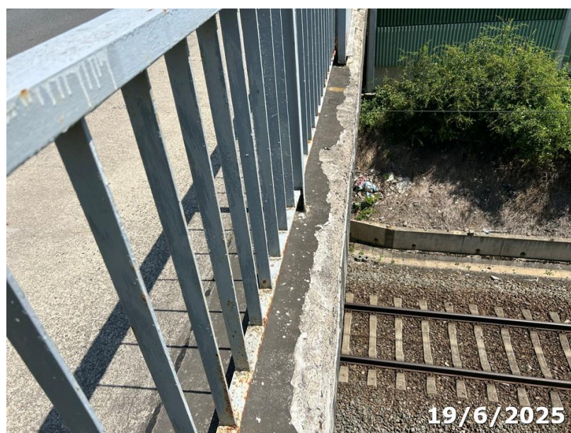
Obr.26 Degradace betonu římsy vlevo, pohled z chodníku
