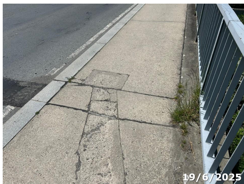
Obr.29 Detail MZ v chodníku vpravo na OP1
