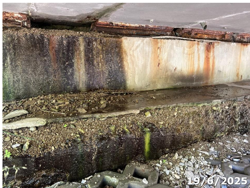
Obr.6 OP1 – pravý okraj, degradace betonu
