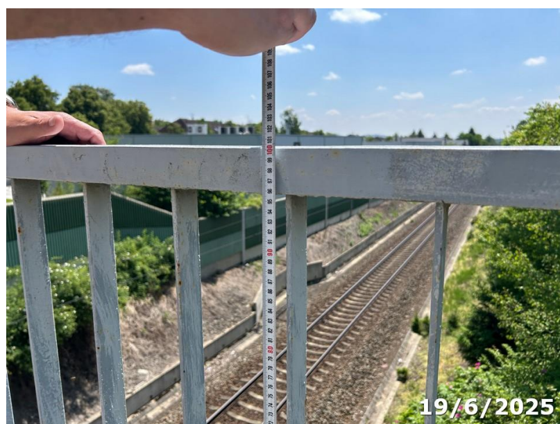
Obr.32 Zábradlí, nenormová výška
