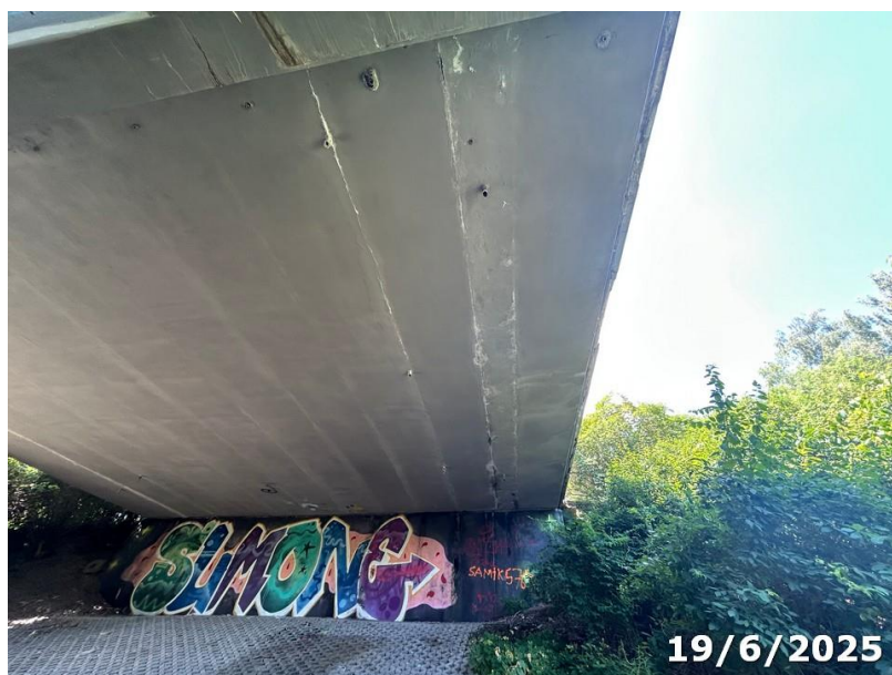
Obr.22 Podhled pole 3, pravý okraj
