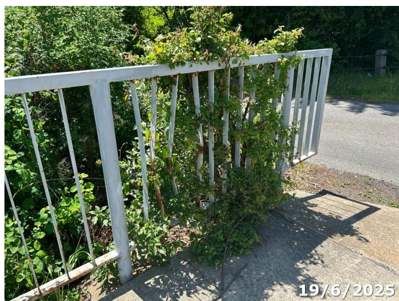
Obr.33 Zábradlí, deformace výplně vlevo za OP4
