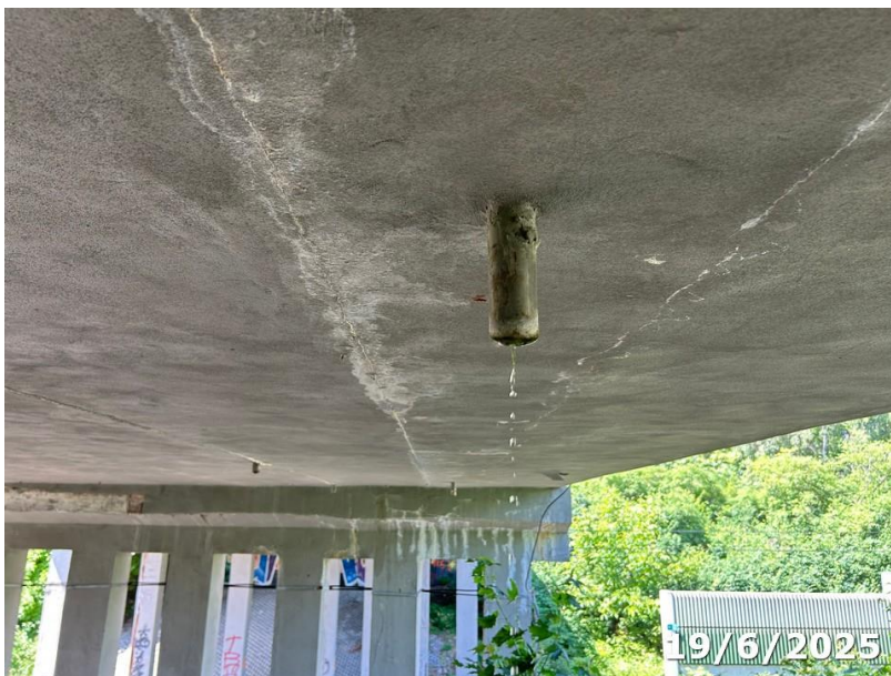
Obr.19 Pole 1, pravý okraj u OP1, voda vytéká z trubičky umístěné v prostoru kanálu pro sítě
