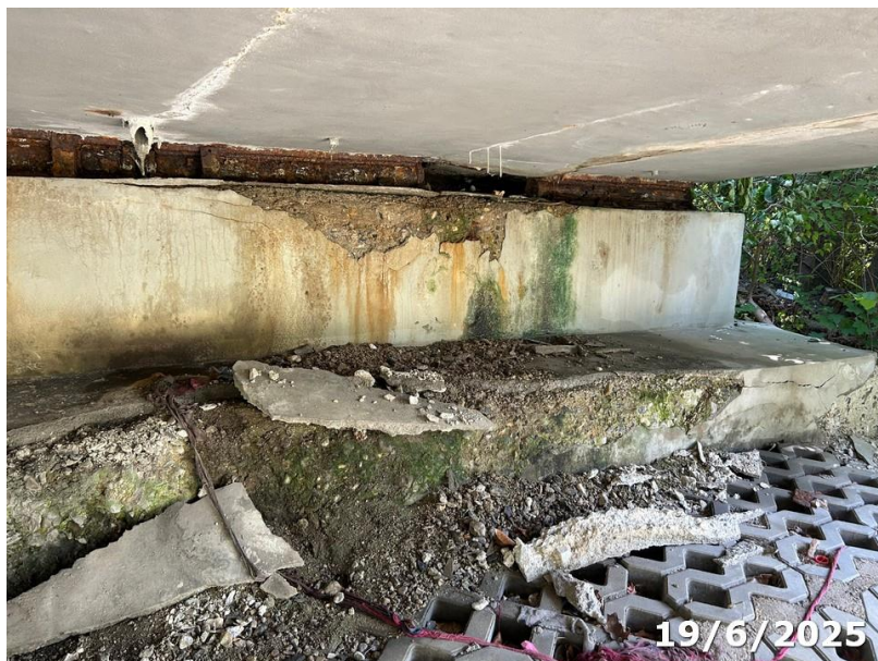
Obr.7 OP1 –levý okraj, degradace betonu
