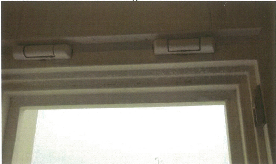
Foto č.5 – kondenzace na osazovacím rámu okenní výplně
