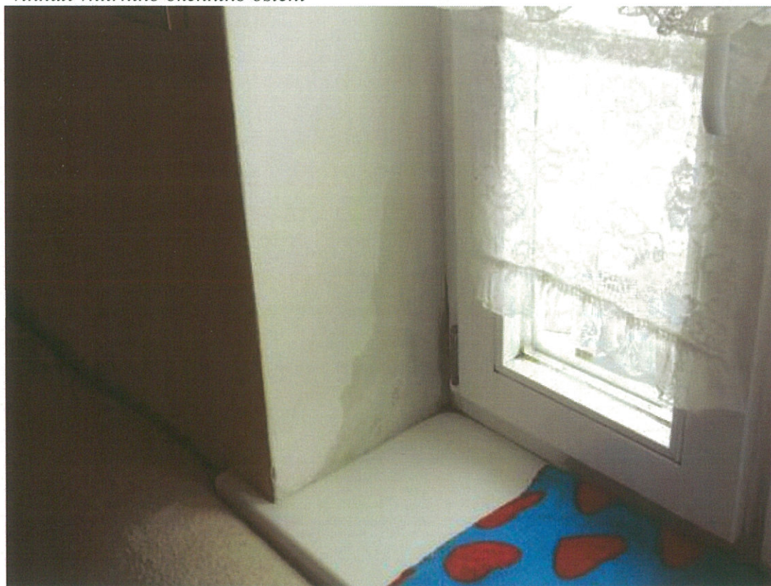
Foto č.1 – vlhnutí vnitřního okenního ostění
