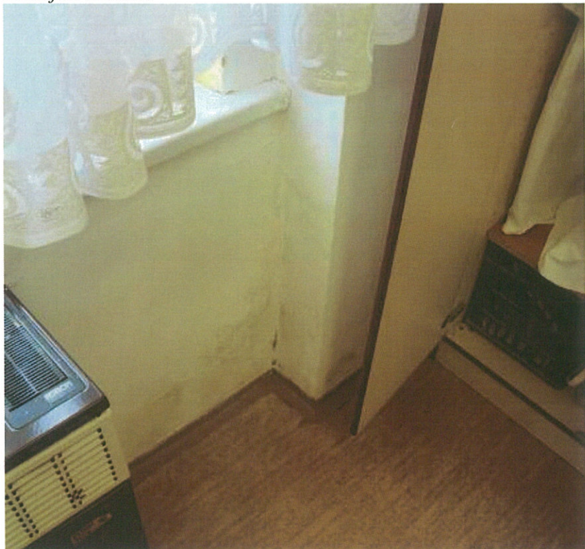
Foto č.9 – obvodové zdivo se vzlínající vlhkostí
